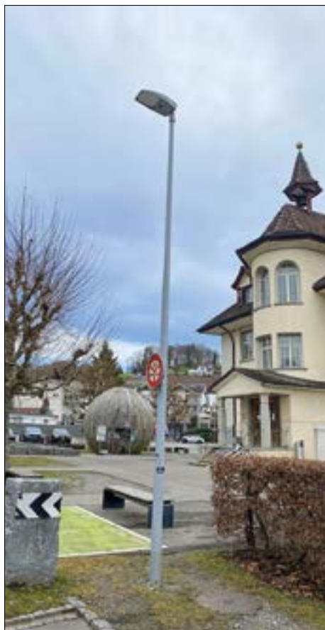
Die Strassenbeleuchtung beim alten Schulhaus: Auch hier kommt neu LED-Technik zum Einsatz. Foto zVg
